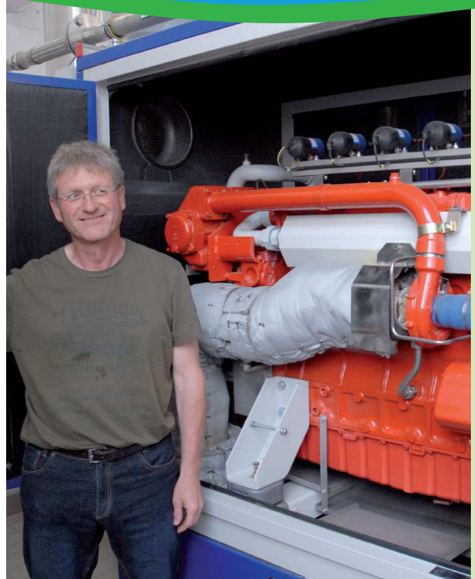
Karl-Heinz Jost ist stolz auf das Blockheizkraftwerk
