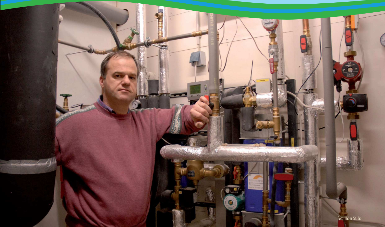
Norbert Klink im Technikraum seines Passivhauses in Reisen
